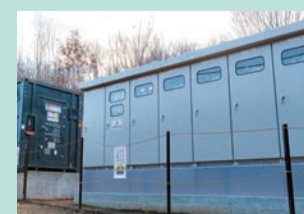
蓄電池、受変電設備 分散型サーバ設備
