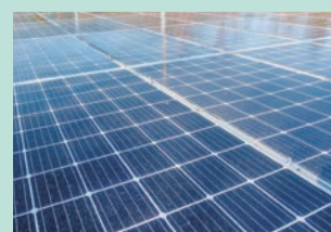
クラウド型太陽光発電所
